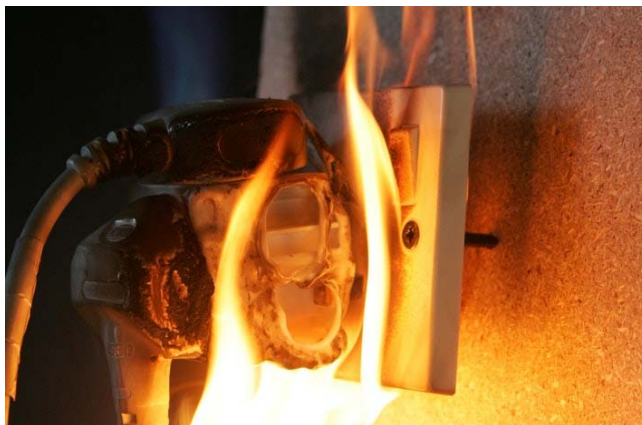
รูปที่ 1.2 แสดงลักษณะเพลิงไหม้เกิดจากไฟฟ้าช็อต
