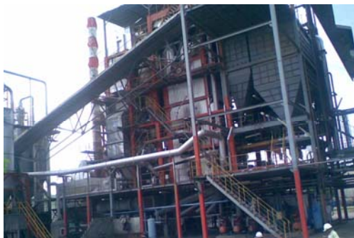
รูปที่ 1.7 โรงไฟฟ้าชีวมวล
